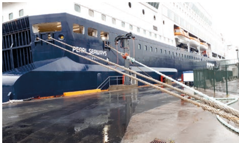
Maasähkön latauslaitte Osloon satamassa (näkyvissä köysien takana).
