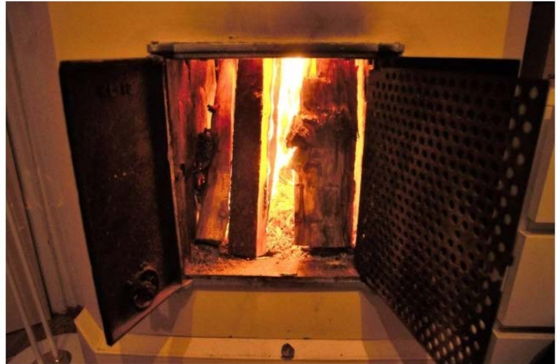
Launeen alueen omakotitaloissa on runsaasti 1950 -1960-luvun tulisijoja. Vanha tulisija voi olla loppuun käytetty, jolloin se lisää haitallisten hiukkasten pääsyä ilmaan. Kuva: Petri Koivisto
